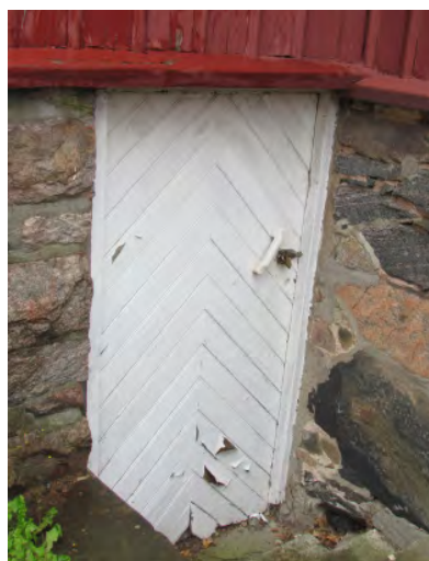
Dörrkarmen i källaren har en större skada där träpartier har lossnat.
