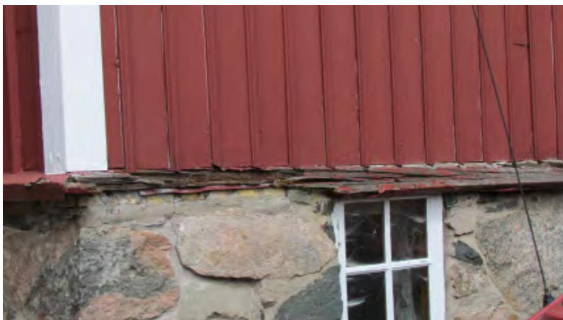
Fot-/vattbrädan är upprutten på södra fasaden vilket sannolikt lett till skador på bottensyllen.
