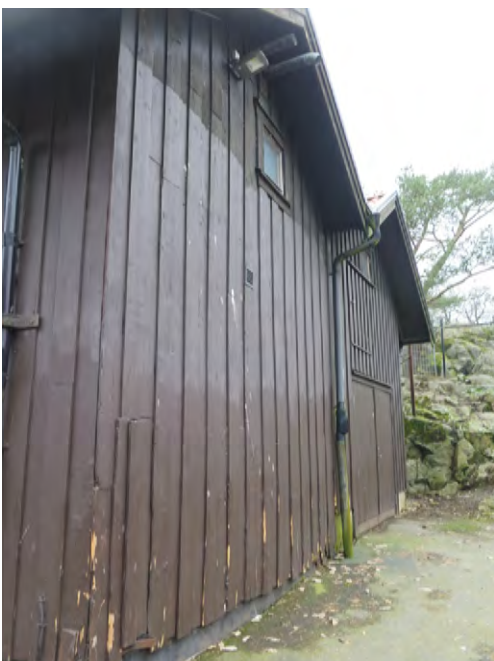
Panelen är "lappad och lagad" vilket ger karaktär åt byggnaden.
