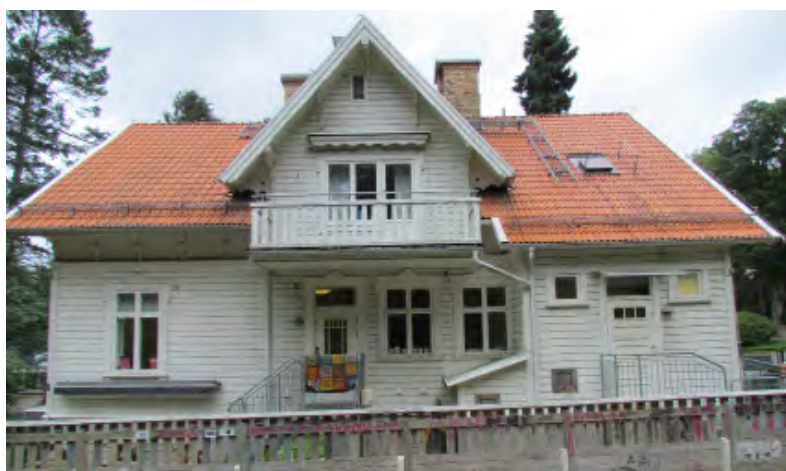
Södra fasaden, med ett originellt takfall. Frontespisens fönster är utbytta. Entréernas trappor och ramper är inte anpassade till byggnaden.
