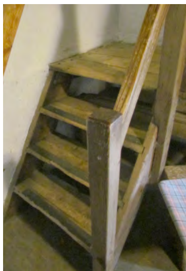
Trappan till över- våningen är brant har en traditionell utformning. Trap- pan är i behov av en ytterst varsam restaurering..
