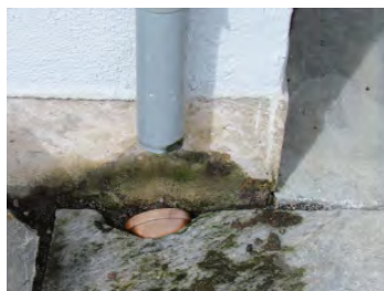
Stuprörets avslutning till mark saknas.
