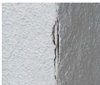
Detalj av spritputs som spruckit.
