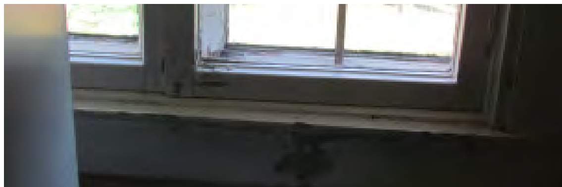
Fuktskadan gör att färgen flagnar och det blir märken på väggen undertill.
