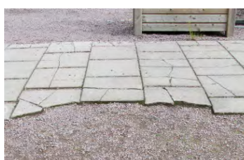
Flera av terrassens markplattor är trasiga.
