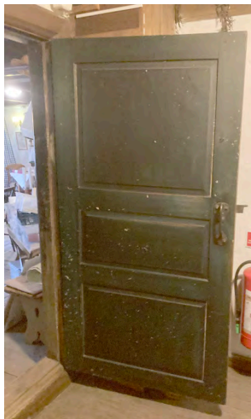
Dörrarna är av äldre modell och har gamla lås och beslag.
