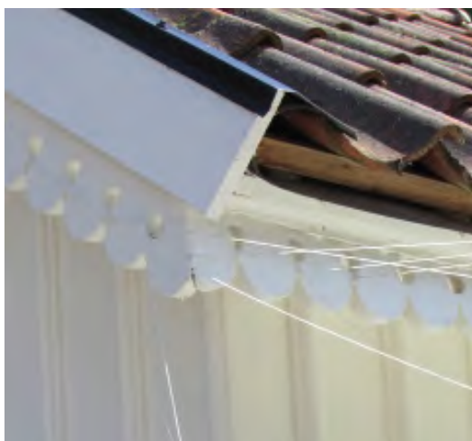
Huset har fått lövsågerier vid takfot och vindbräda.
