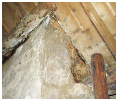
En fuktskada vid mötet mellan murstock och tak ser ut att vara pågående, möjligen med svampavväxt.
