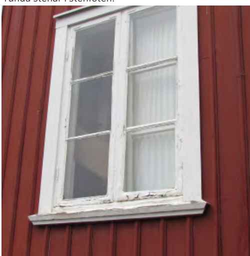
De äldre fönstren är av god kvalitet. Dessa ska renoveras.
