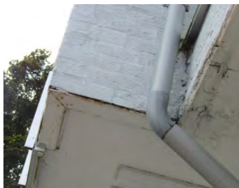
Detalj av den utskjutande delen. Här har metallsconingen rostade.
